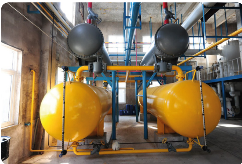
Contenedor Recibidor con Recipiente de Apoyo para Amoniaco
