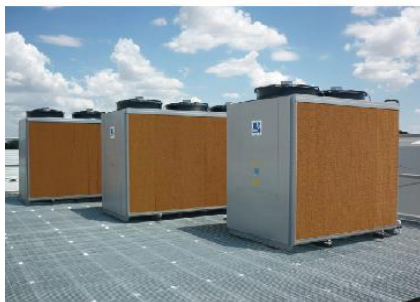
Intercambiador de Calor
