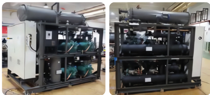
Unidad condensadora gemela para laboratorio.
