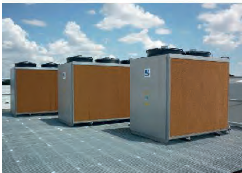
Intercambiador de Calor
