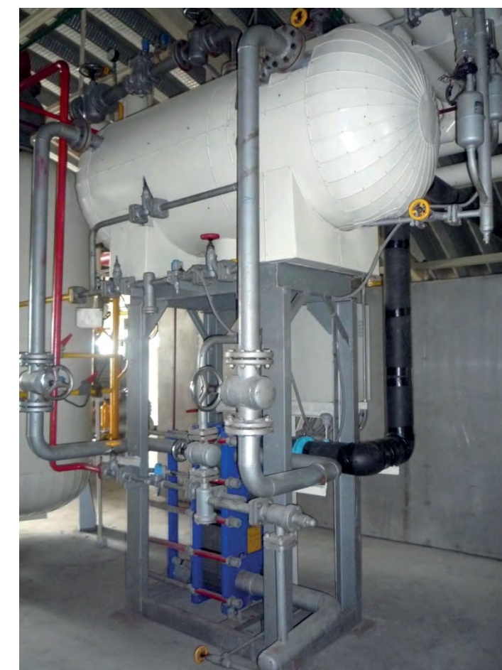
Enfriadora de Agua Modular
